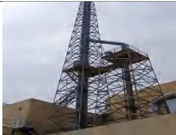
焚烧车间废气排气筒
