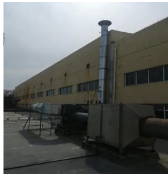
1#危废间排气筒
