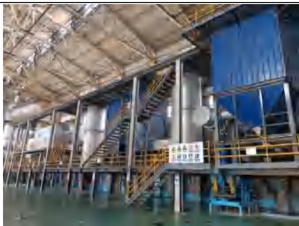
高氮焚烧装置废气治理设施
