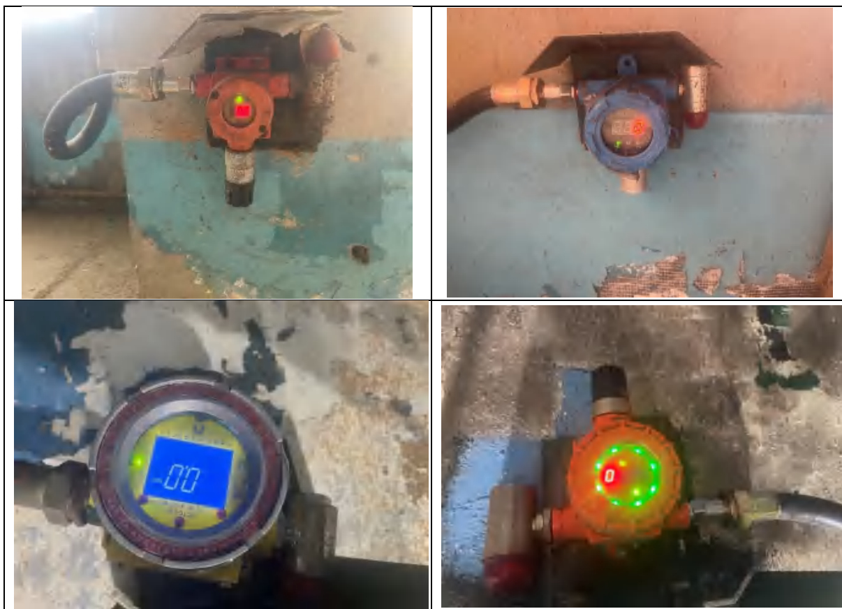
图 5.2-2 可燃气体、有毒气体泄漏检测报警仪
