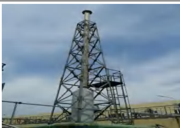
污水处理厂废气排气筒
