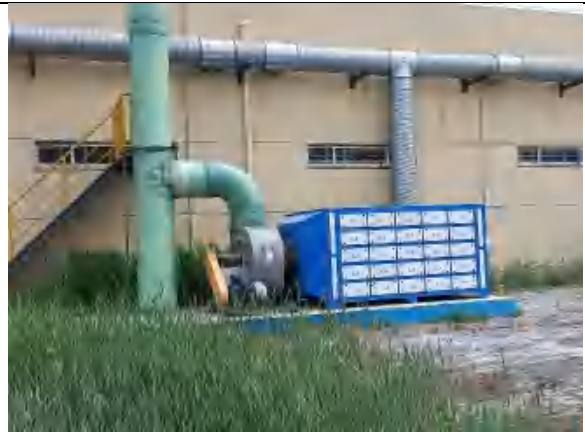
2#危废间排气筒
